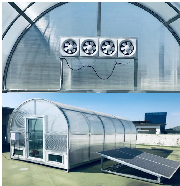
ภาพที่ 4.3 ติดตั้งพัดลมระบายอากาศและแผ่นโซลาร์เซลล์
